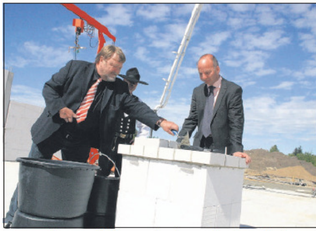
Investor Herbert Wenzel (l.) gestern bei der Grundsteinlegung für den Netto-Markt mit Polier Thomas Bolbeth und Christian Kuffer von der Grundstücksentwicklungsgesellschaft Hansestadt Wismar. Foto: Hoff
